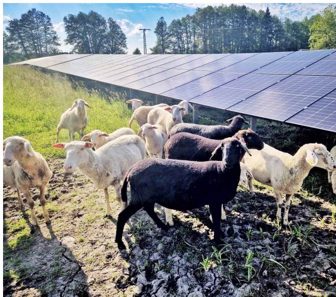
PV-Anlage bei Mineralbrunnen Krumbach GmbH in Kißlegg
